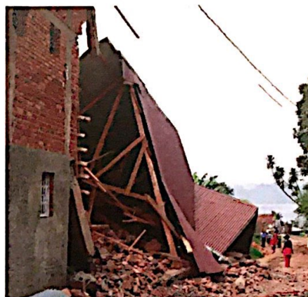
Maison effondrée par un tremblement de terre
