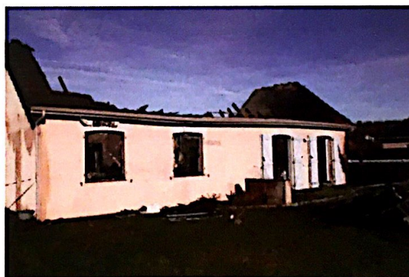
Maison détruite par un incendie.
