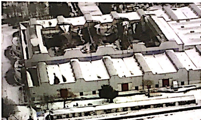
Toit d'un parc des expositions effondré par la neige.
